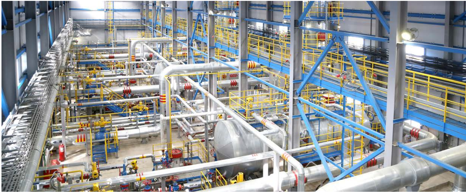
На Установке комплексной подготовки газа № 1 Ковыктинского месторождения. Репортаж с УКПГ-1 читайте на стр. 2
