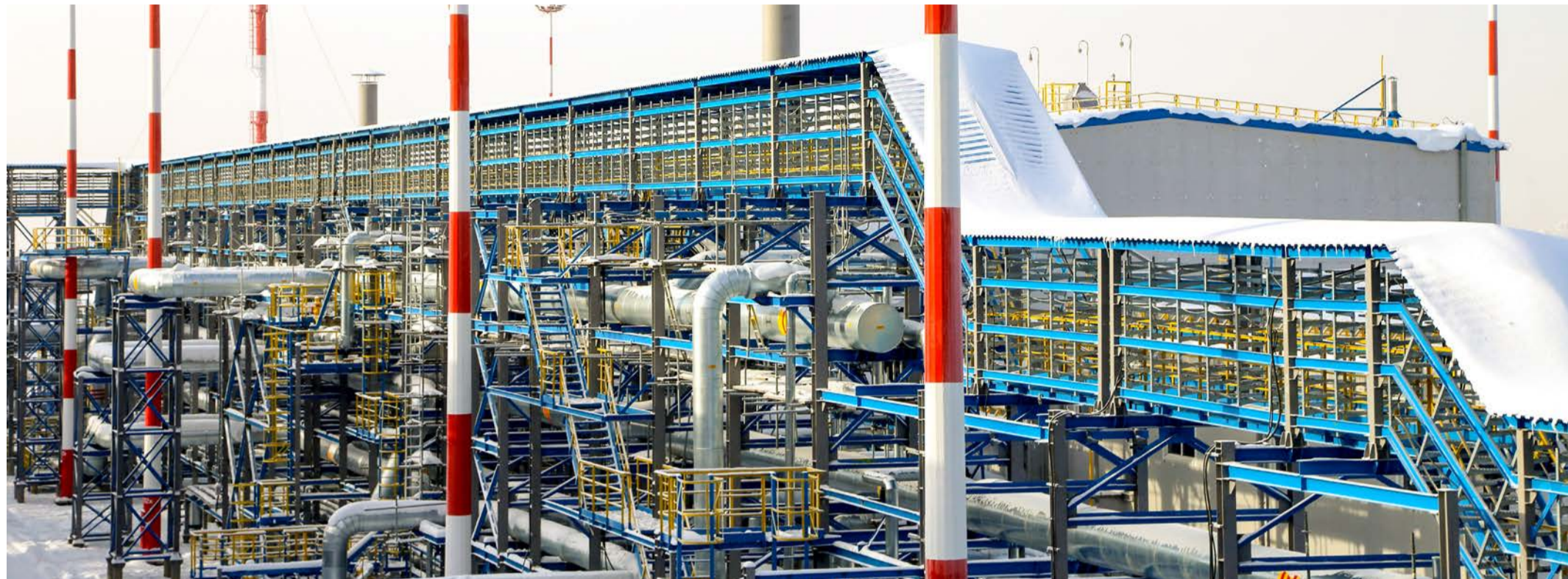
Установка комплексной подготовки газа № 1 Ковыктинского газоконденсатного месторождения
