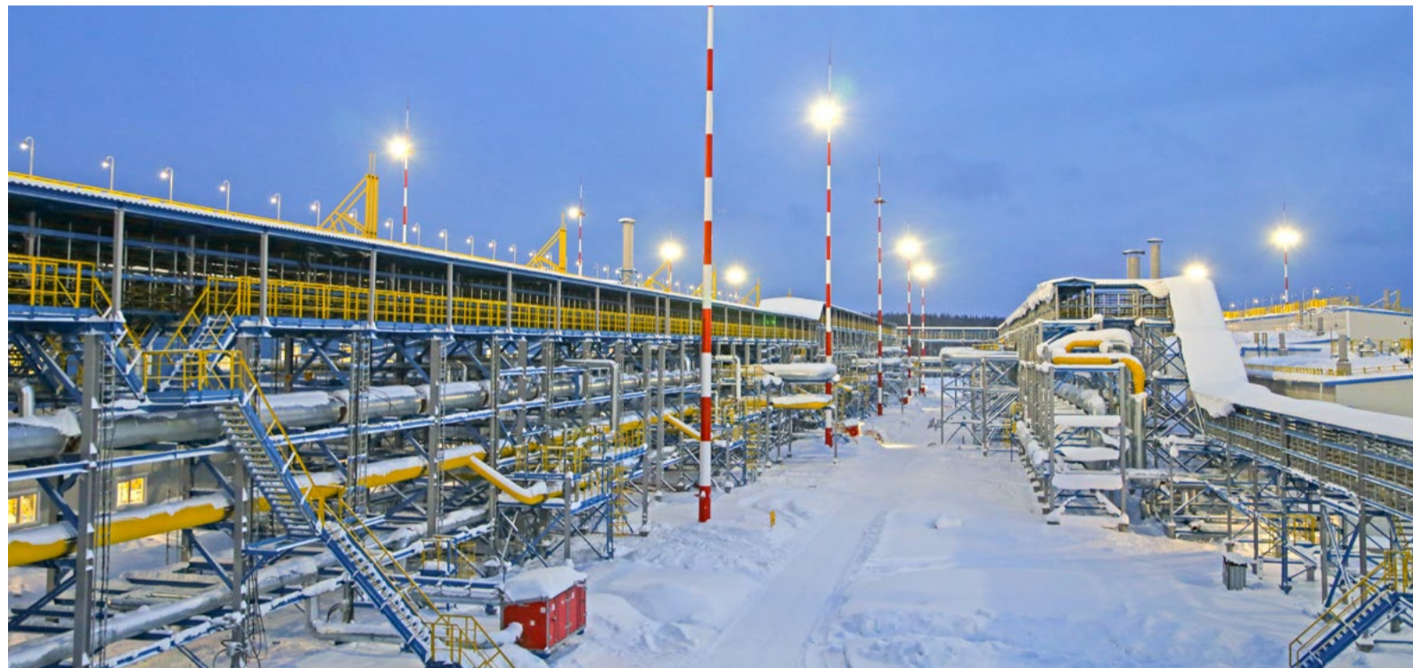
Установка комплексной подготовки газа № 3 Ковыктинского газоконденсатного месторождения
