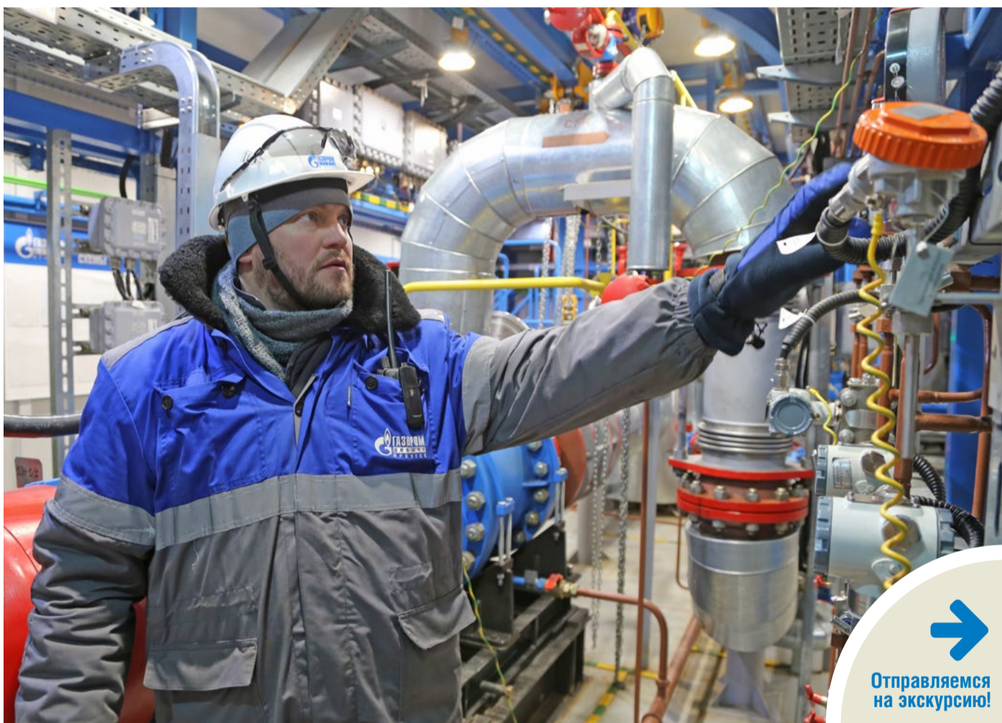
Начальник механоремонтного участка Цеха отгрузки стабильного конденсата в поселке Окунайском Управления материально-технического снабжения и комплектации Денис Шерстянкин провел для «Иркутского газовика» экскурсию по промплощадке и ответил на все наши вопросы
