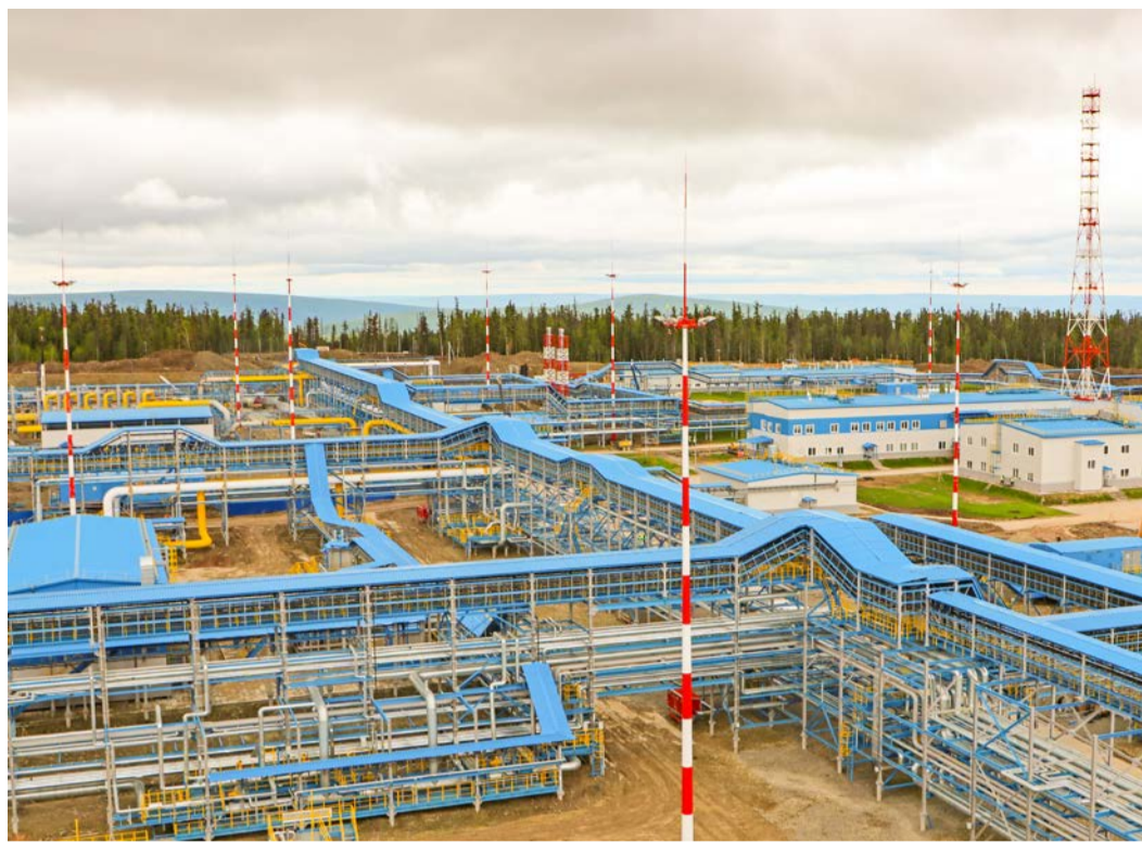
Природный газ Ковыкты поставляется в магистральный газопровод «Сила Сибири» с УКПП-2. В проекте обустройства месторождения предусмотрено строительство еще трех таких установок
