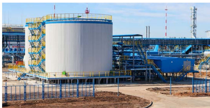
Добытый на Ковыктинском месторождении газовый конденсат по 170-километровому конденсатопроводу подается на Терминал отгрузки в поселке Окунайском на Байкало-Амурской магистрали. Отсюда этот ценный продукт поставляется потребителям в цистернах по железной дороге
