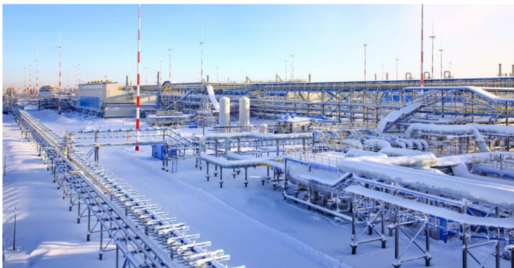
Площадка установки комплексной подготовки газа № 2 (УКПП-2) Ковыктинского месторождения
