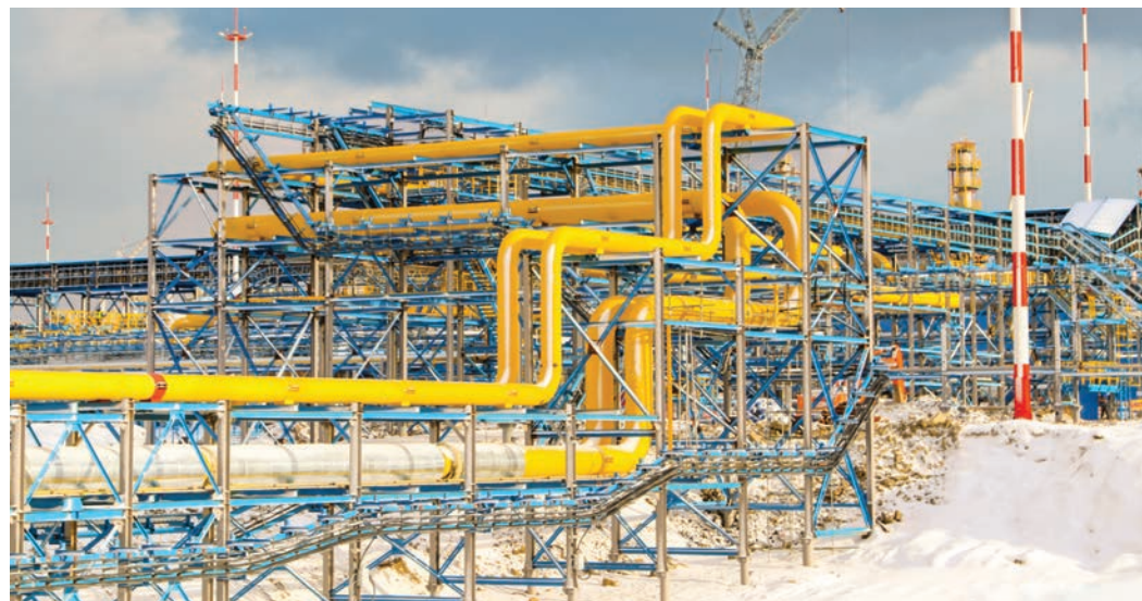
На УКПГ-2 смонтировано 17,5 тысячи тонн металлоконструкций зданий и эстакад, проложено 2800 километров кабельно-проводниковой продукции. Объем построенных монолитных железобетонных конструкций достиг 28 тысяч кубометров
